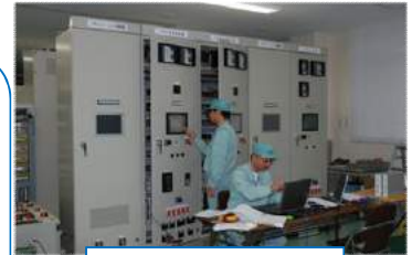
制御保護装置(水力発電所)
