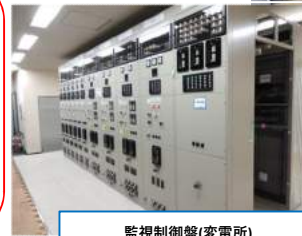
監視制御盤(変電所)
