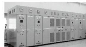
京極発電所 ロードセンター
