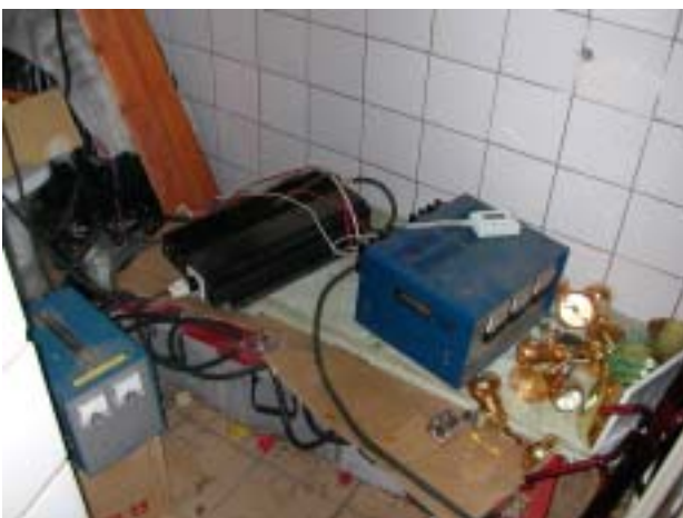
図8 制御室（中央左がインバータ，中央右が過充・放電防止回路，それらの下にバッテリーが見える）
