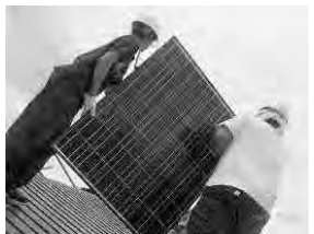
図7. 太陽電池パネル
